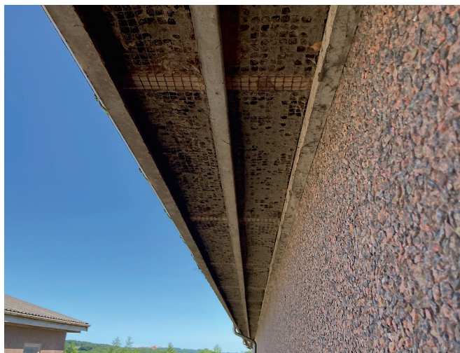
Luftindtaget til en diffus-ventileret stald bliver begrænset af skidt og støv i udhænget.
