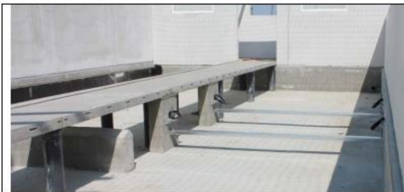
Figur 1. Vejeceller i gyllekanal før montering af gødningsopsamlingsbakke.
