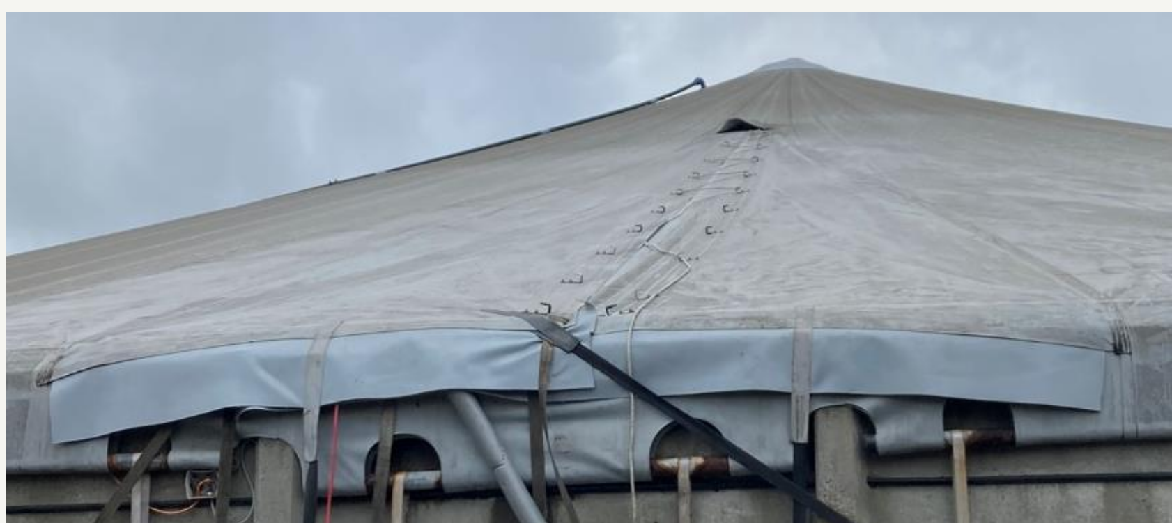
Tank A: Modificeret traditionel teltoverdækning. Forlængelse af trekantsluger for at minimere metan udslip langs gylletankens kant.
